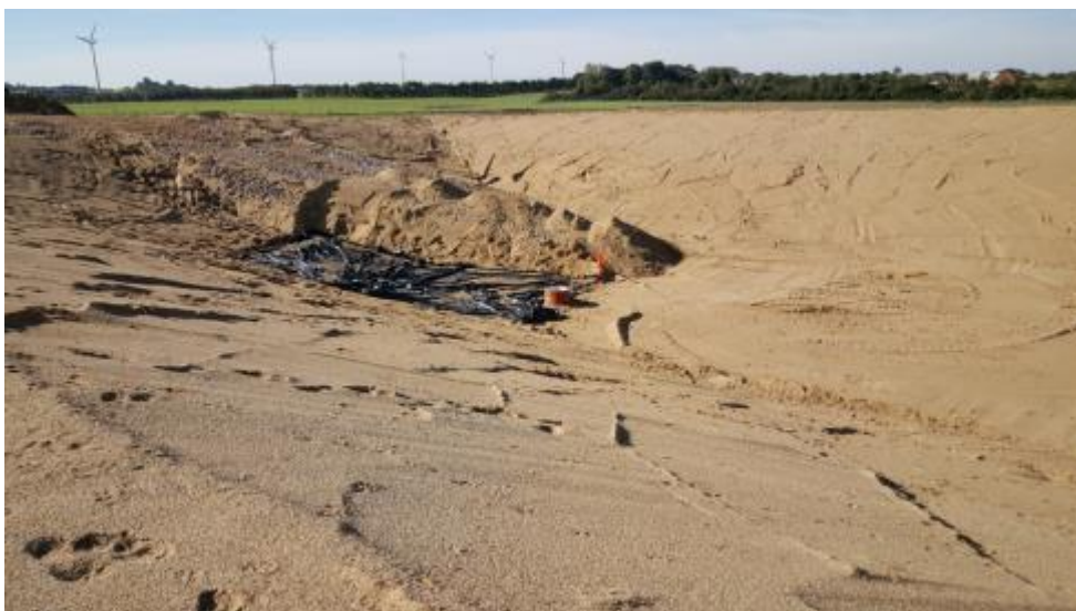
Figur 2: Entreprenøren havde glemt at støbe betonplade over udløbsbygværk. Støbningen er først udført kort tid før tilsynet. Pladen er afdækket af landbrugsplast ifm. hærdning. Umiddelbart nedenfor til højre for landbrugsplasten ses brøndring etableret midlertidig for bortpumpning af rent regnvand, indtil enheden tages i brug.
