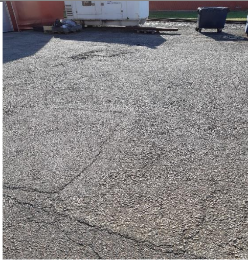
Belægningen på den gamle brandøvelsesplads, der ikke bruges mere. Der har ikke været anvendt skum på arealet.
