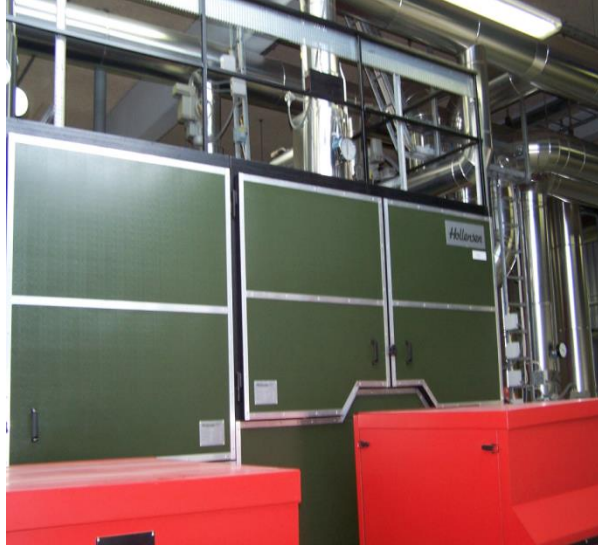
Værkets 2 gaskedler med indfyret effekt hhv. 2,72 og 4,35 MW.
