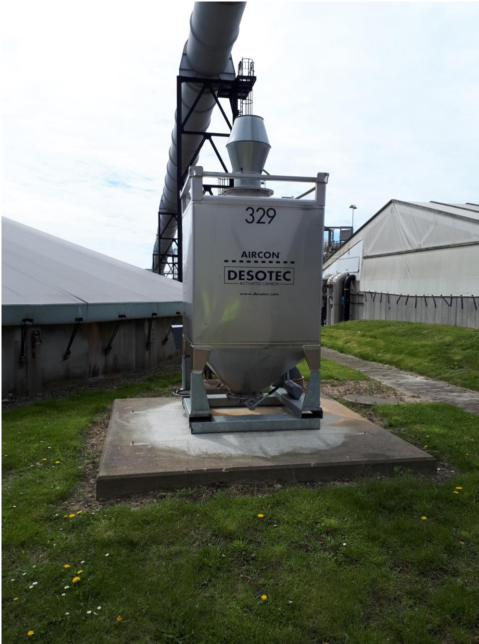
Kulfilter til rensning af luft fra tanke.
