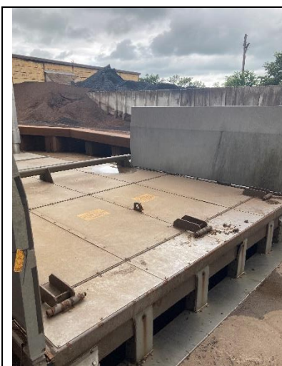
Fig. 6 Underjordisk silo til spildevandsslam.
