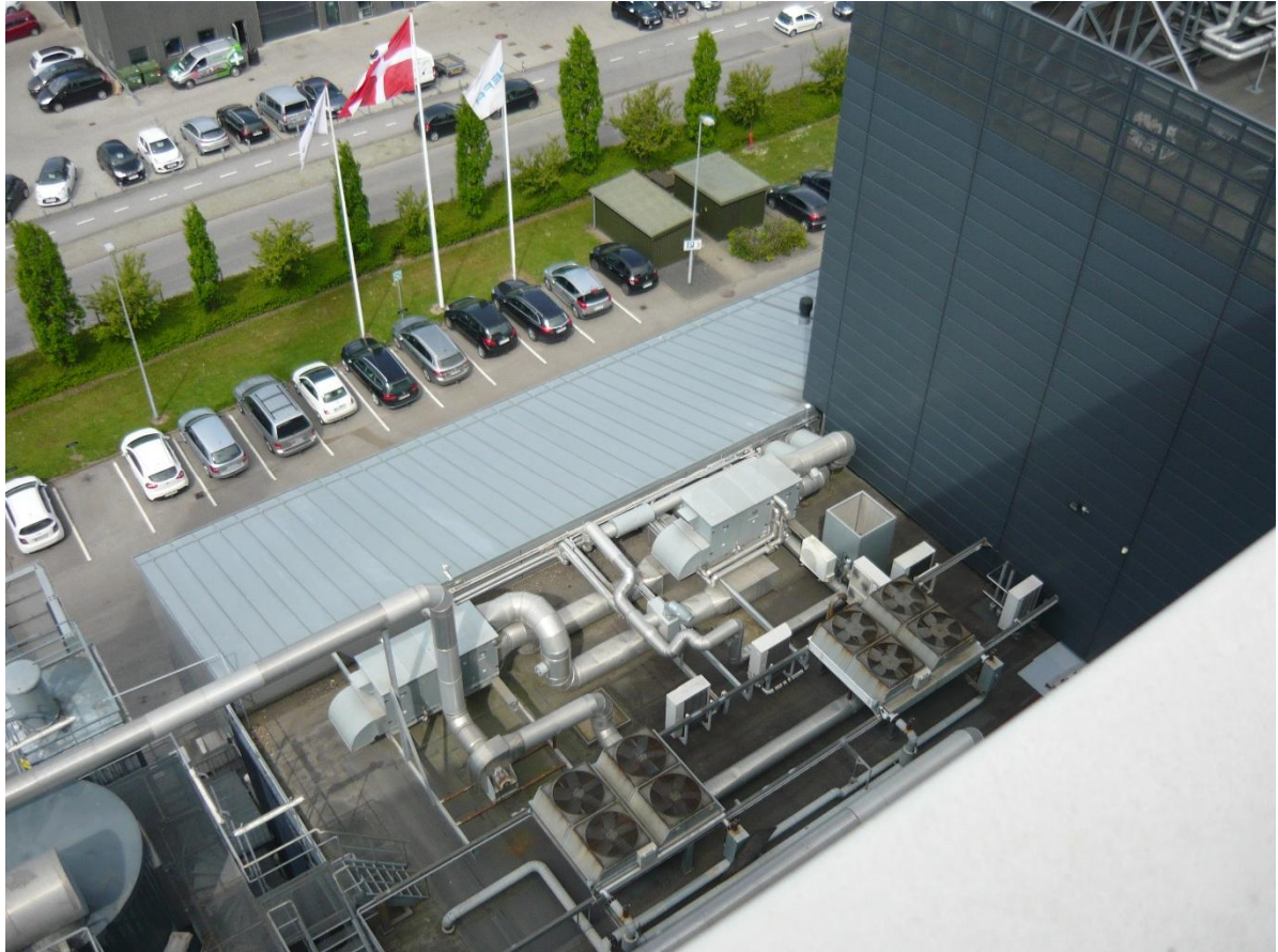
Figur 8: Tørkølere og ventilation på tag af ovnhal 2
