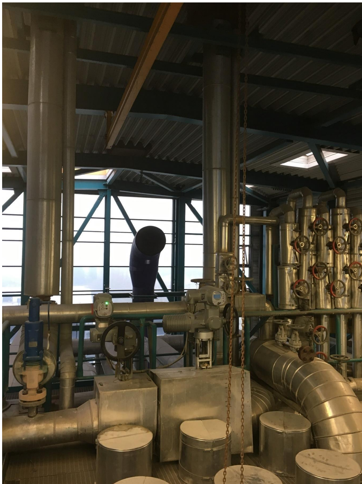
Figur 25. Opstartsventilen placeret under tag i ovnhallen.
