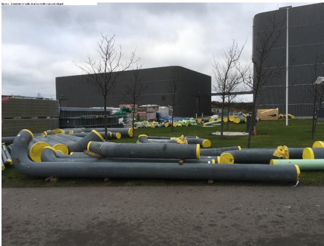
Billede 2a og 2b – Besigtigelse af udendørs arealer med midlertidigt opbevaring af byggemateriale
