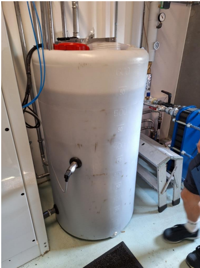
Figur 4) Buffertank som bruges til prøvetagning
