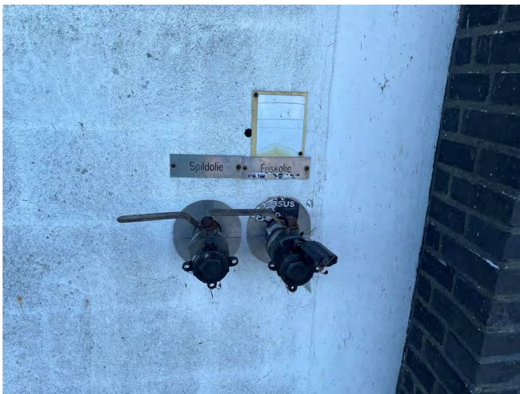
Foto 2: Påfyldningsstuds uden for gasmotorrum bygningen.
