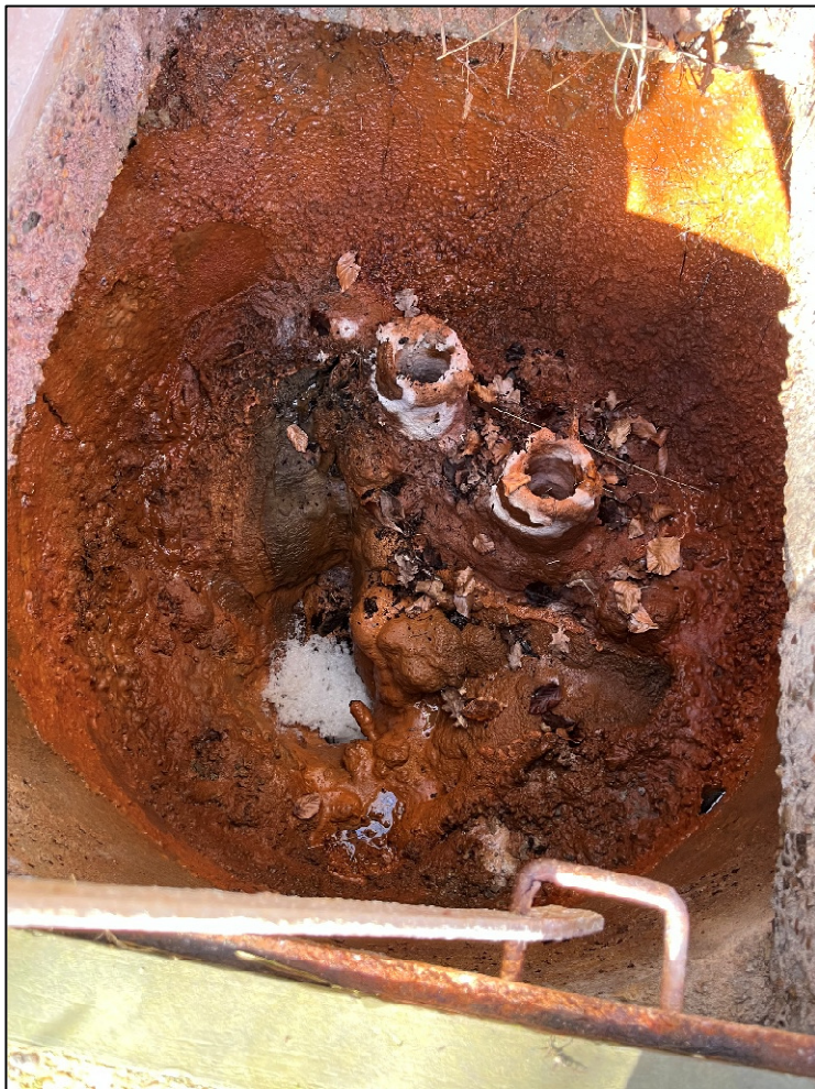
Foto 5: Kig ned i perkولاتsamlebrønd.
