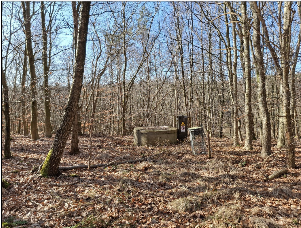
Foto 3: Perkolatbrønd 1, som modtager perkolat fra Etape 1.
