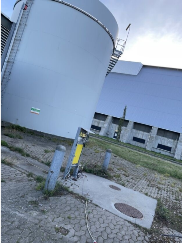
Figur 4 Baggrund: Ammoniakvandstank - Forgrund: Dæksler til opsamlingssumpen.
