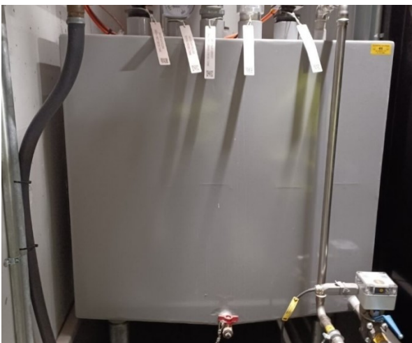
Figur 19 Olietank til nødstrømsanlægget.
