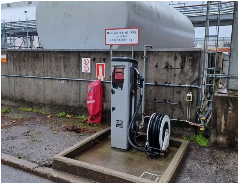
Figur 29 Til påfyldning af Amagerværkets køretøjer.
