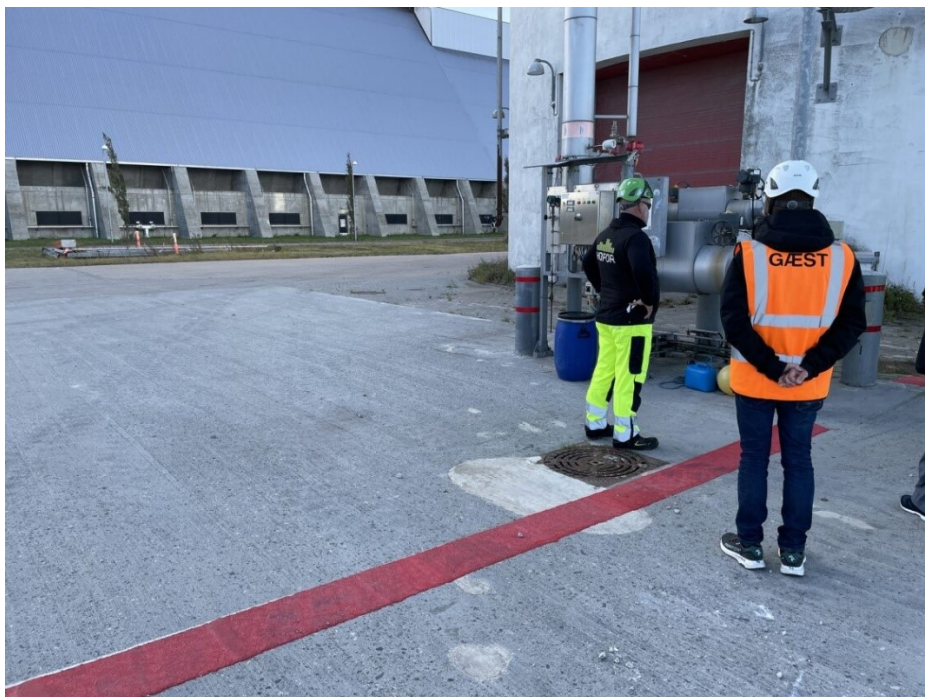
Figur 2 Påfyldningsplads for letolieanlægget.
