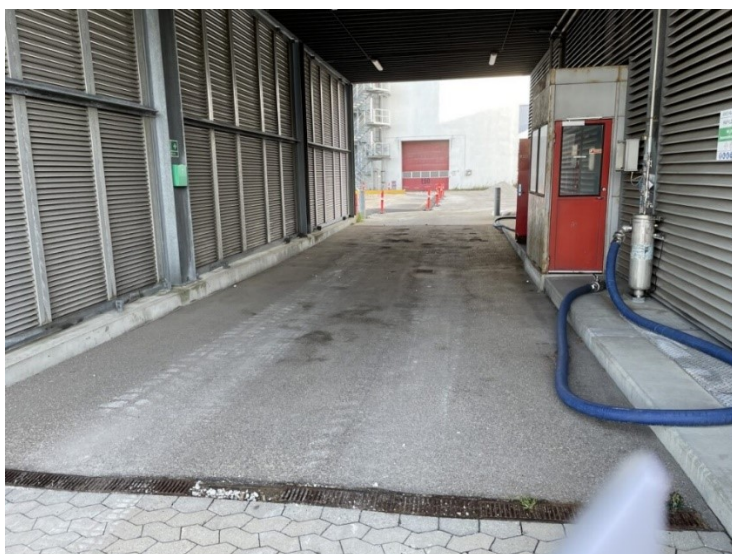
Figur 3 Påfyldningsplads for ammoniakvandstanken.
