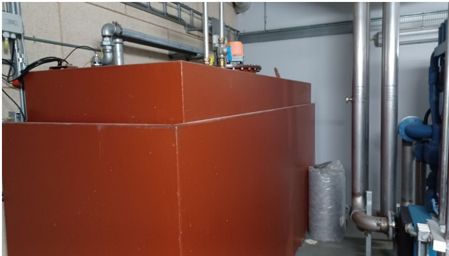
Figur 20 Olietanken der hører til nødstrømsanlægget (AMV 1) er placeret indendørs og er hævet over gulvet.
