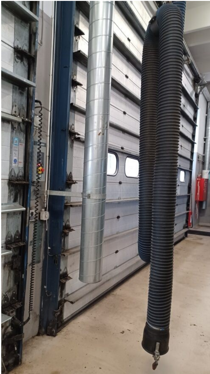
Figur 25 Udsugning - Flexslange i værkstedet.
