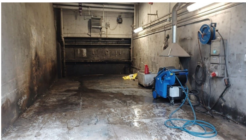
Figur 32 Højtryksspulerum ved dozerværksted.
