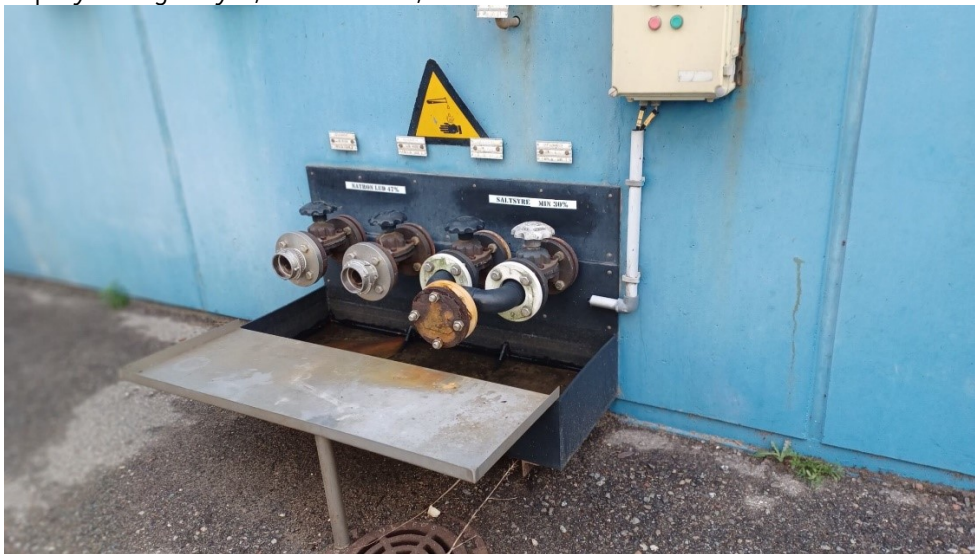
Figur 37 Påfyldningsstudse til saltsyre og lud ved neutralisationsbasisnet.
