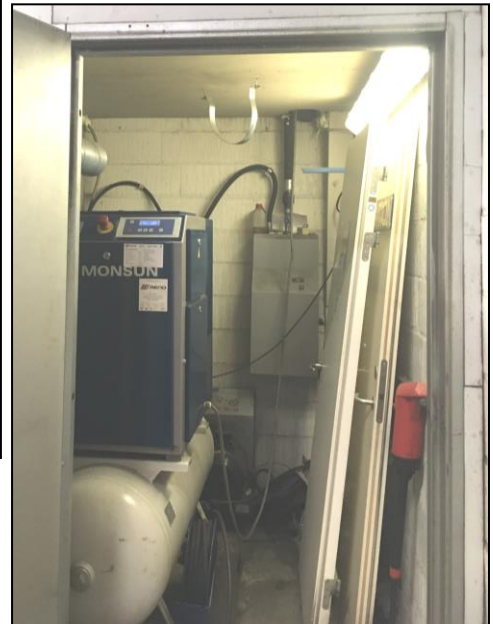
Herunder foto af kompressoren i lukket rum på lageret.
