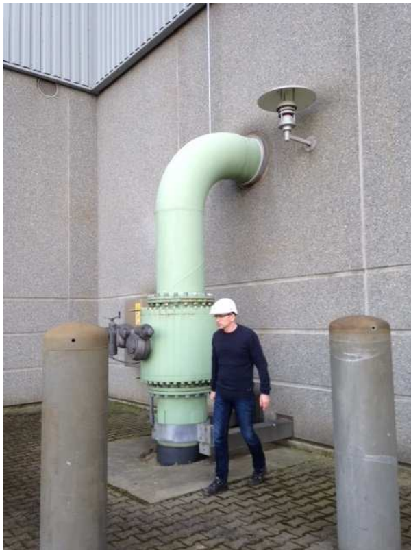
Foto: Eksisterende gasforsyning til Blok 3, tilgang kedelbygning.
