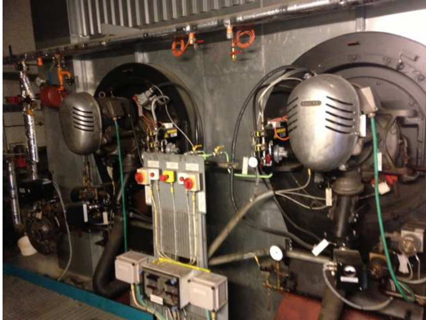
Foto: Eksisterende oliebrændere på hjælpedampkedlen.
