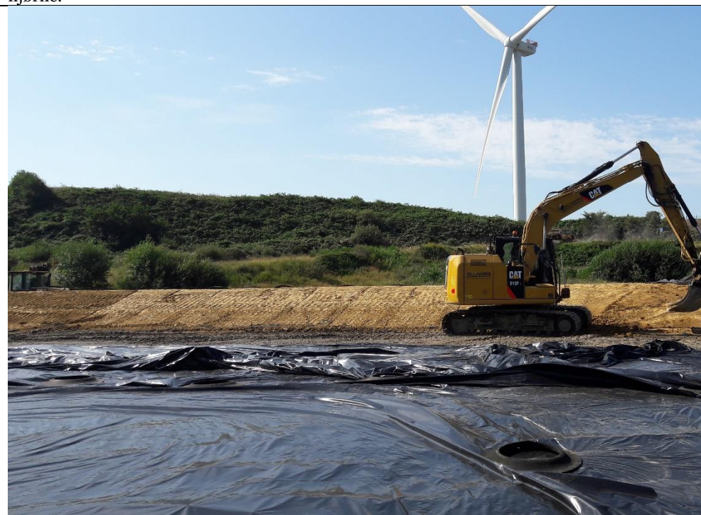
Foto 8: Foto af etapens sydvestlige randvold, under afretning af lermembranens overflade med gravko.
