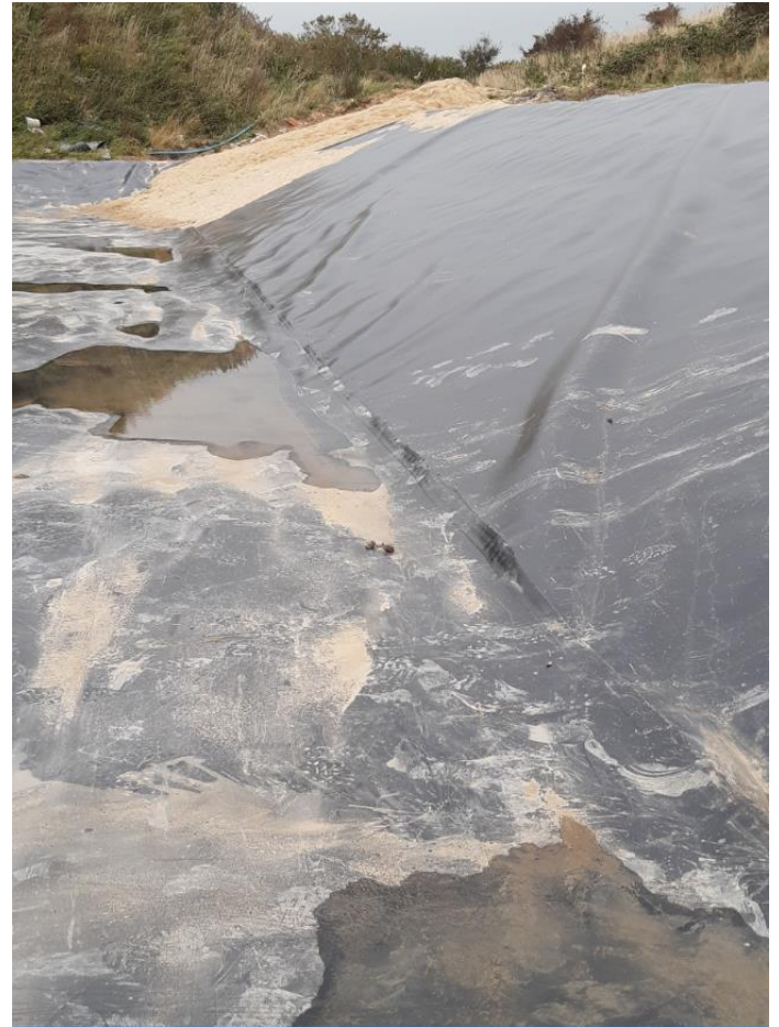
Foto 21 østlig skråning med svejsning med overlap den forkerte vej.
