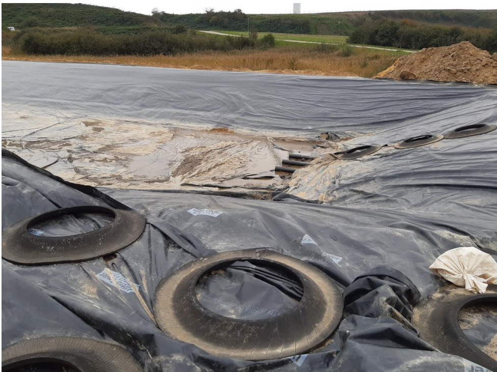
Foto 11 udløbsdræn i vestlig enden af enheden
