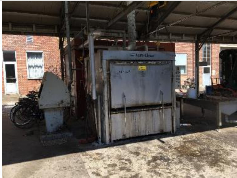
Udendørs vaskeanlæg under halvtag
