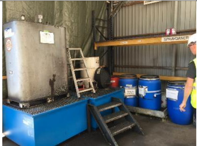
Spildolietank på spildbakke under halvtag
