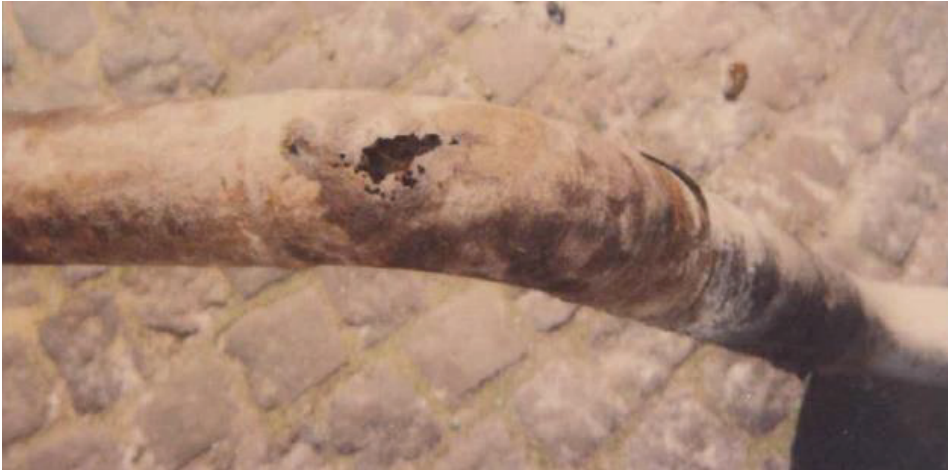
Figur 4.5 Foto fra 1990 af utæt rør, tank 18.
