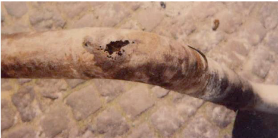
Figur 6.5 Foto fra 1990 af utæt rør, tank 18.
