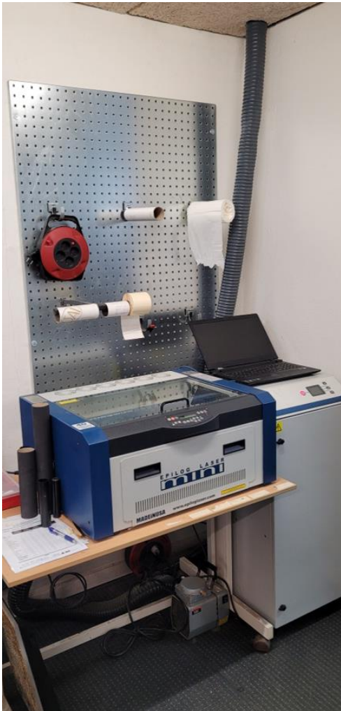
Udsugning ved graveringsmaskine føres op på loftet.
