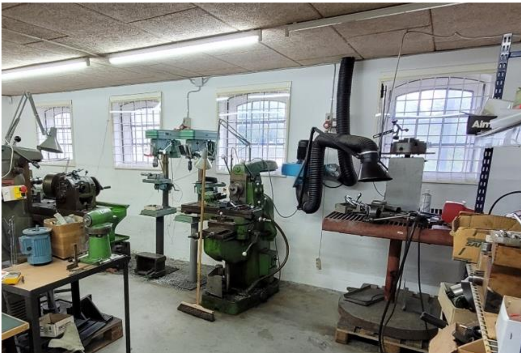
Punktudsugning til svejsning m.m. føres op på loftet.
