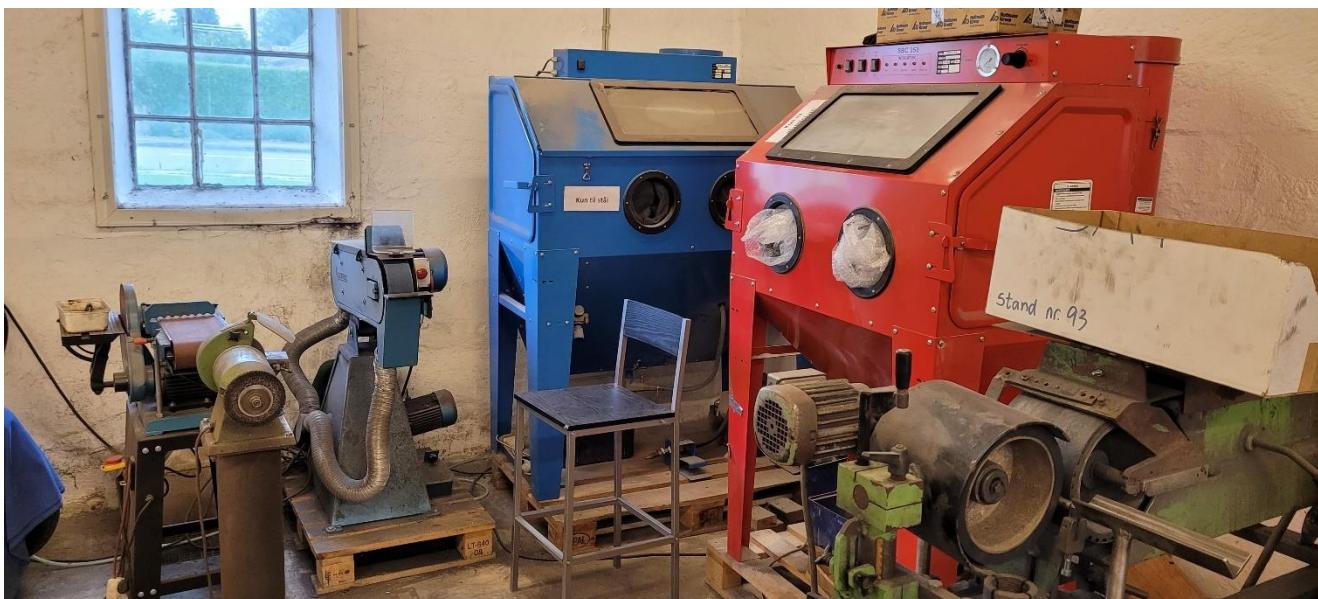
Slibeudstyr og glasblæsning i tilstødende lager/værksted. Der er ingen luftafkast/udsugning ved maskinerne.
