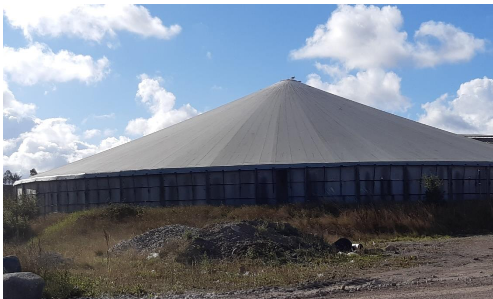
Billede 6 Overdækket perkolattank med en kapacitet på 5.000 m 3 .
