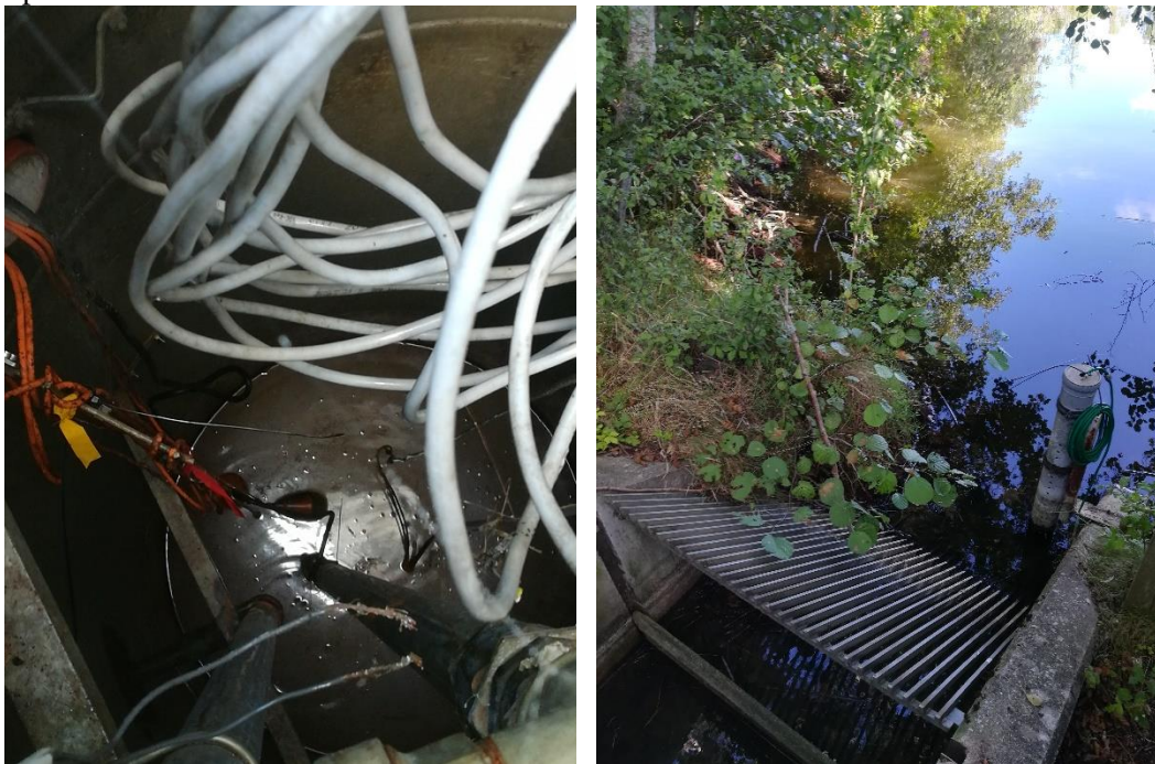
Billede 7 Venstre: nede i brønden med måleudstyr til måling af vandstanden. Højre: afledning til omfangskanalen.
