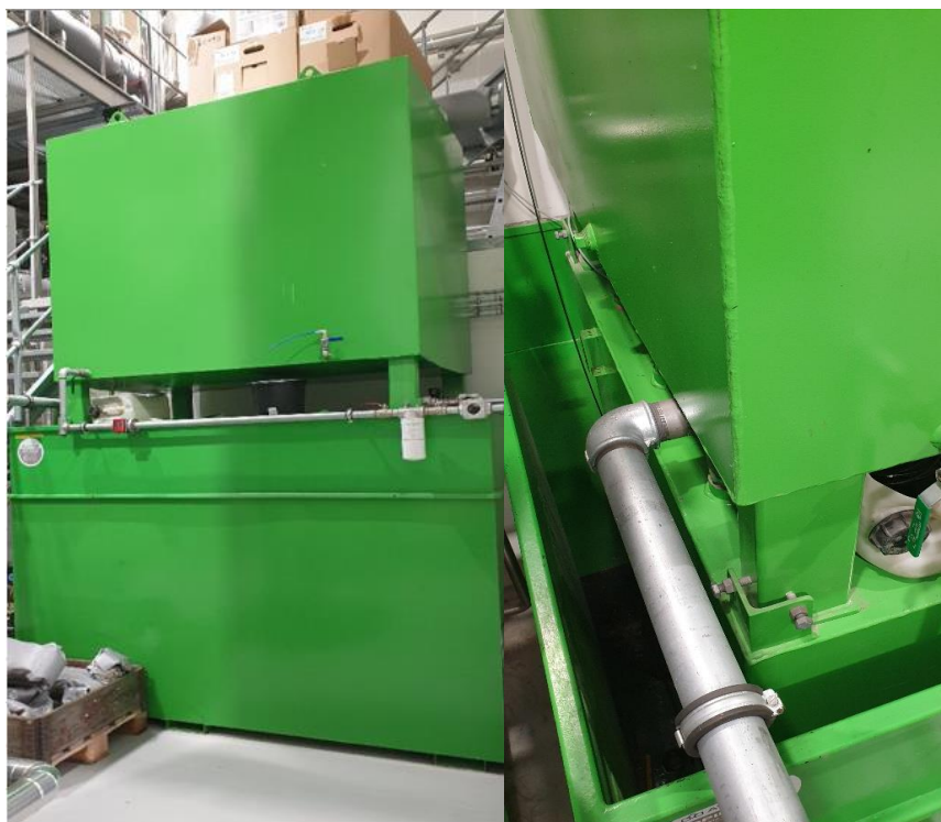
Figur 10. Tankene og rørføring i biogasbygningen
