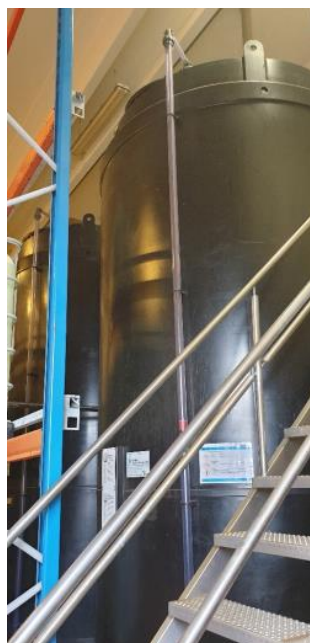
Figur 8. Modtagelse ved indpumpning – rørsystem går direkte til specifikt brugssted (d.2)
