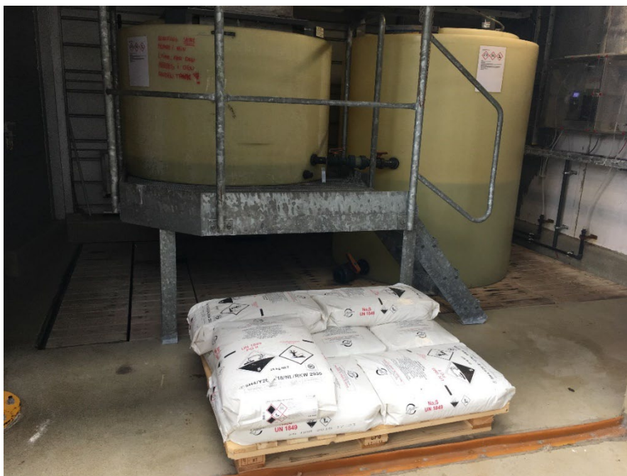
Figur 20. Oplag af Natriumsulfid of opblandingsbeholder. Bemærk opkant ved port (forrest) og træafdækning over betongrupe.
