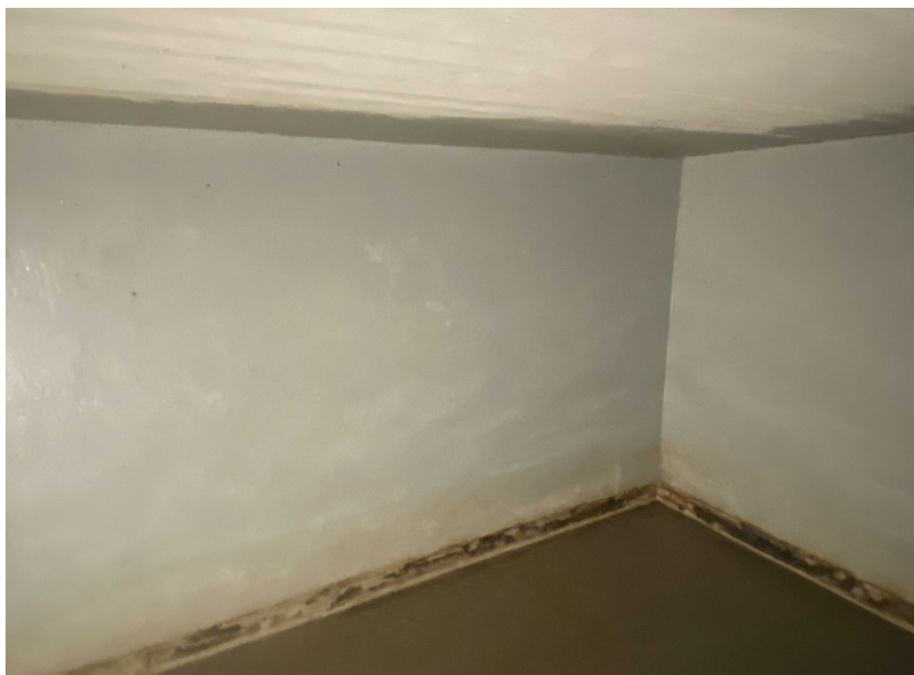
Figur 32 Eksempel på tilstand af betonkar for opsamling af olie fra transformere på blok 1.
