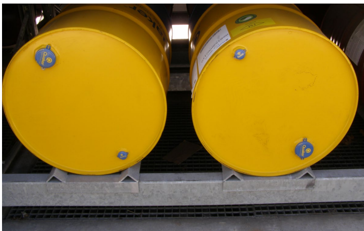
Figur 6. Oliefad på reol over beton opsamlingskar.
