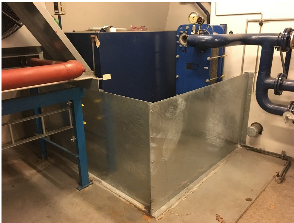
Figur 15. Brændstoftank for nødstrømsanlæg blok 1. Olie tanken står i kar sammen med varmeveksler.
