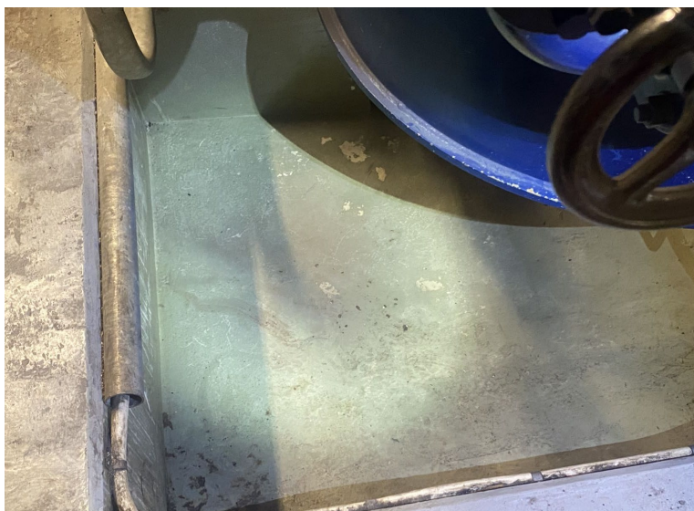
Figur 31 Foto af del af betonkar under AVV1 reservestarttransformer.
