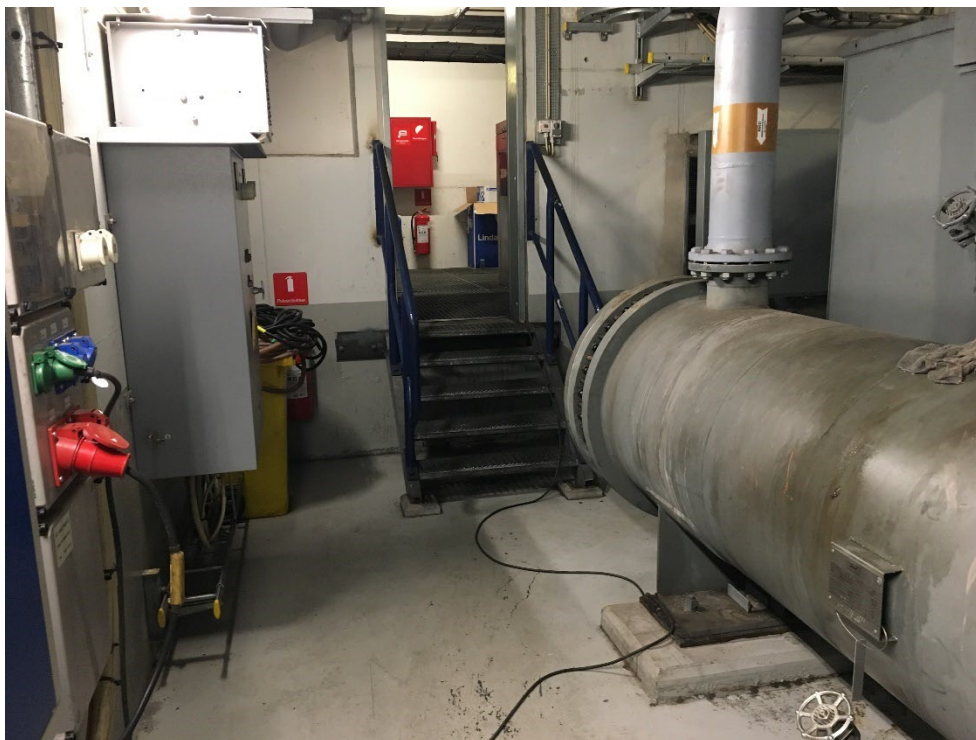
Figur 13 Smøre og styre olierum for turbine. Bemærk trappen op til udgang.
