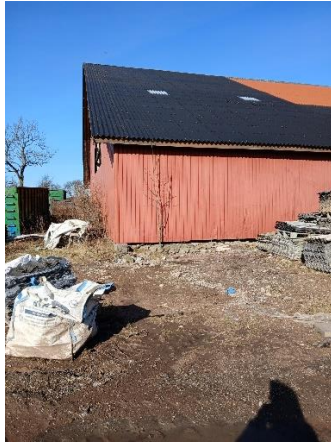
Påbegyndt oprydning ved tagplader
