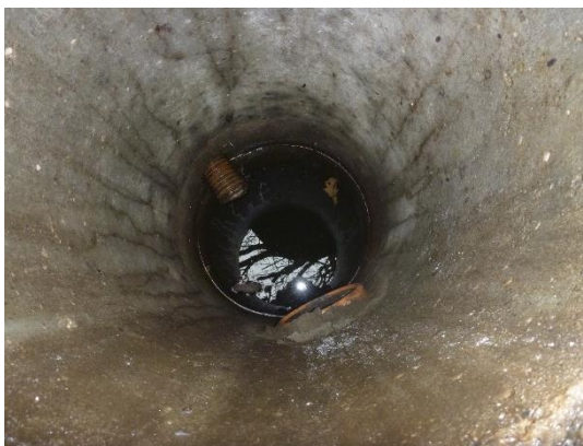
Figur 5: Brønden hvorfra drænvand ledes til Donse Å. Drænvand løber ind i brønden fra deponiet via det lave, smalle rør og ud i åen via det brede rør.
