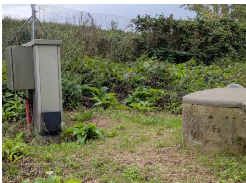
Foto 4. Drænbrønd til perkolat og overfladevand og tilhørende el-skab.
