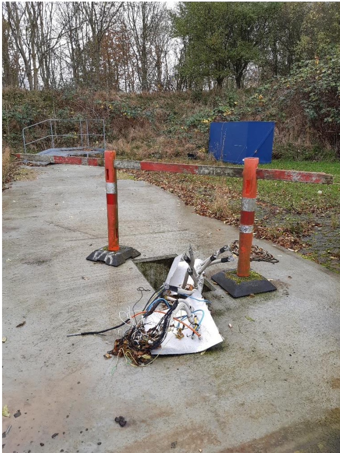
Foto 1. Kobling til gasmotor. Gasmotor er indkøbt, men ikke tilkoblet pga. mangeldende tilladelse hos energiforsyningen.
