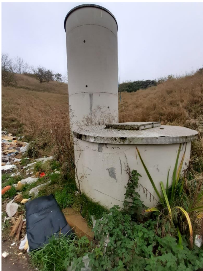
Foto. Stor perkolatbrønd på enhed 4.2.2 oplagsplads
