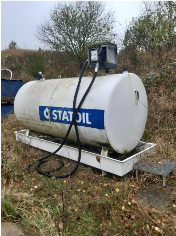
Foto 2 Fritstående olietank. Ved opkørsel til omlastepladsen Ved olietanken ses ikke synlige tegn på spild eller utætheder.
