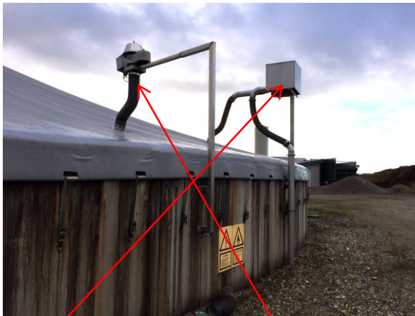
Billede nr. 7 (2018): Måler til registrering af trykket, samt pumpe til biogassen.
