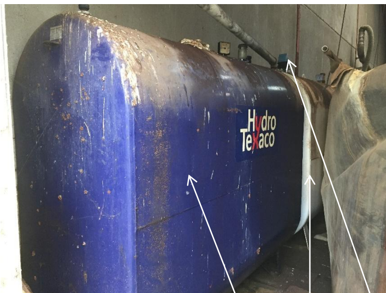
Billede nr. 10 (2018): Olietanke til opbevaring af spildolie og fyringsolie, niveualarm
