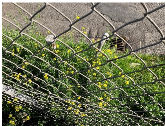
Foto 3: Studse på tømt nedgravet skumtank
