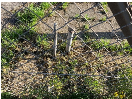
Foto 2: Studse på tømt nedgravet skumtank
