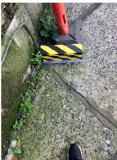
Foto 7: Plantevækst i tankgård ved fuger
