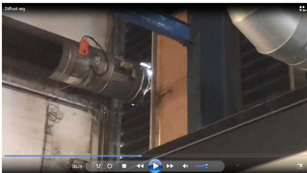
Billede fra video. Kanalen fra udsugningspunktet der fører til filteret.
