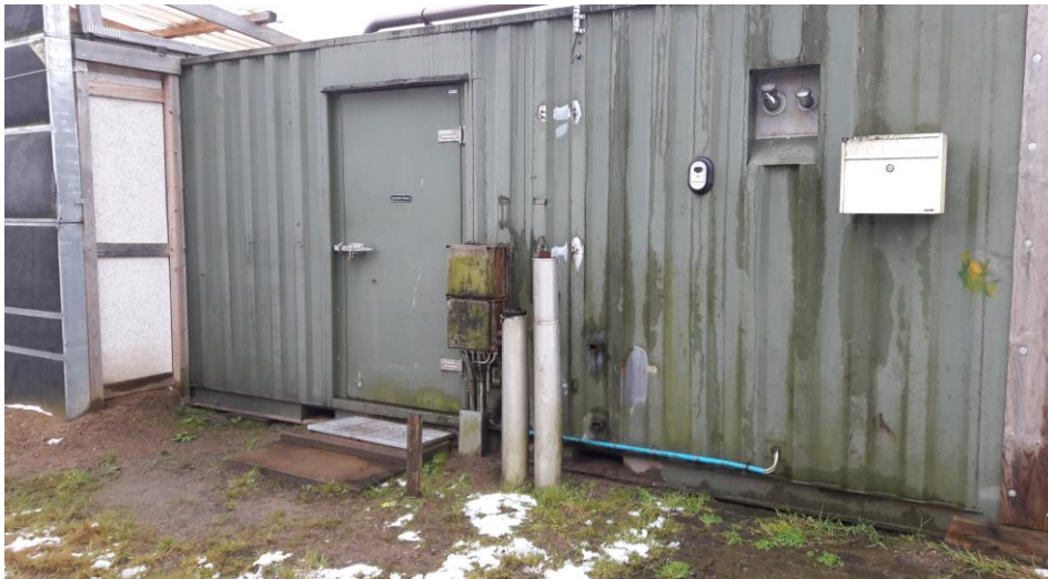
Figur 5. Påfyldningsstuds til diesel til kombimotor.
