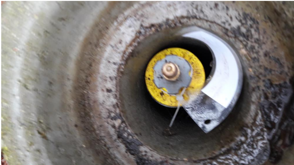
Figur 8. Gasmoniteringsboring med ventil.
