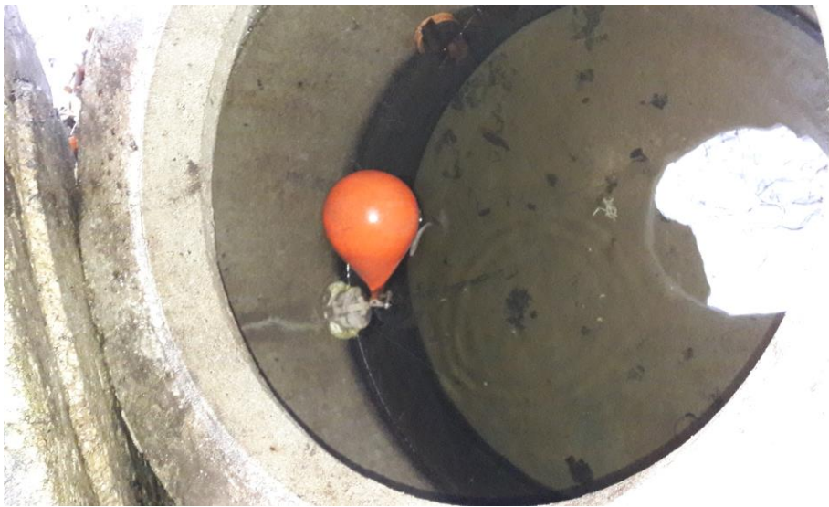
Figur 3. Overløbsbrønd for overfladevand ved nedsivningsanlæg langs omfangs-grøften i deponiets sydøstlige hjørne.
