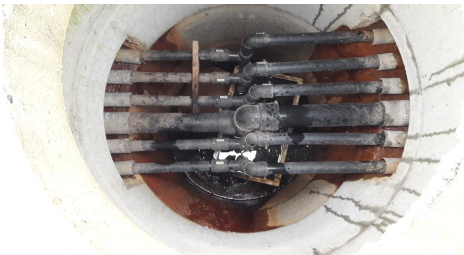
Figur 6. Åben gasfordelerbrønd hvor gasledninger fra hele deponiet samles inden det ledes til gasmotoren.
