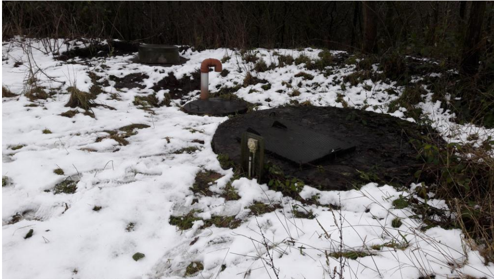
Figur 9. Perkolatsamlebrønd og pumpebrønd 2 til perkolat.
