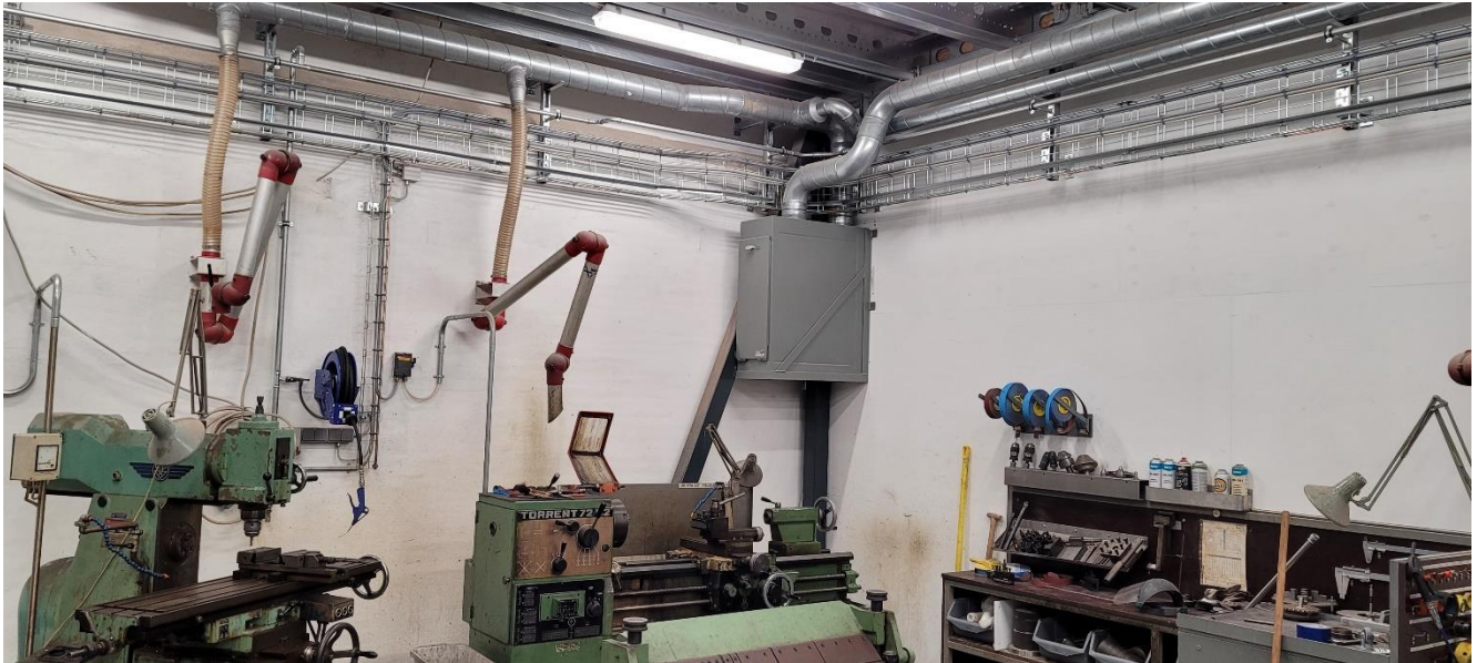
Udsugning ved spåntagende maskiner renses i et olietågefilter.
