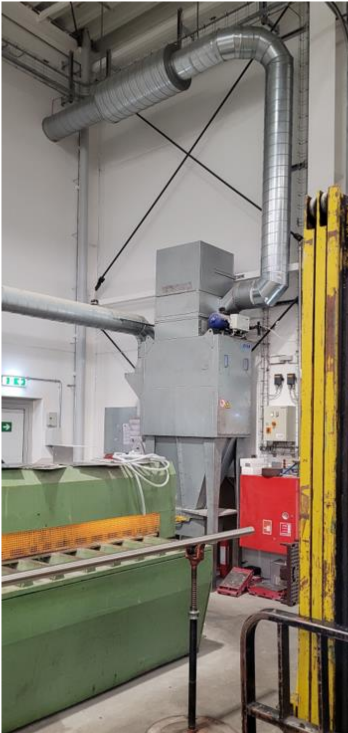
Udsugning fra metalværkstedet renses i et kuvertfilter.
