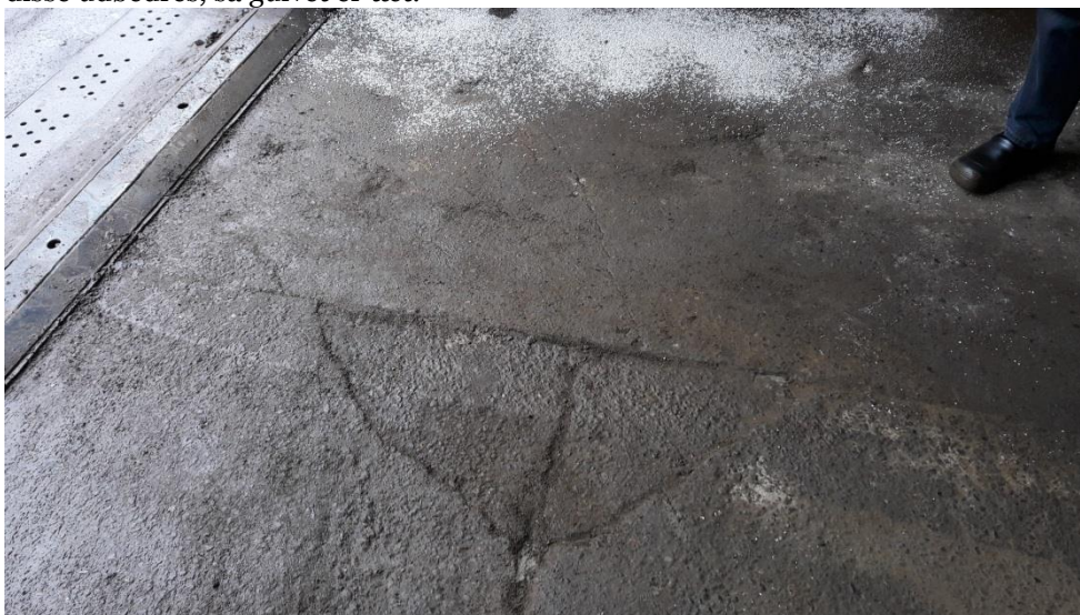
Revnet gulv ved port 10/indenfor indgang i hal 12. Der foregår tankning af trucks på arealet.
