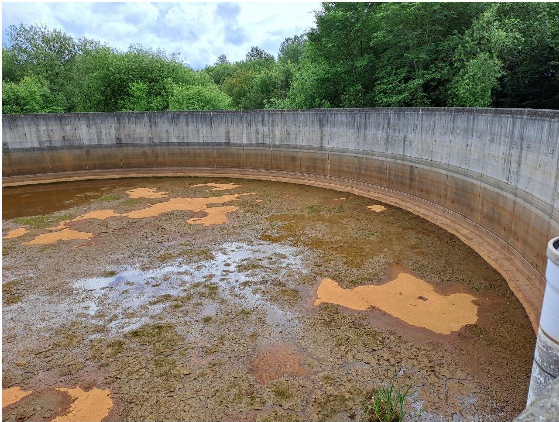
Figur 5: Tørlagt gylletank, som bruges som bufferbassin til perkolat
