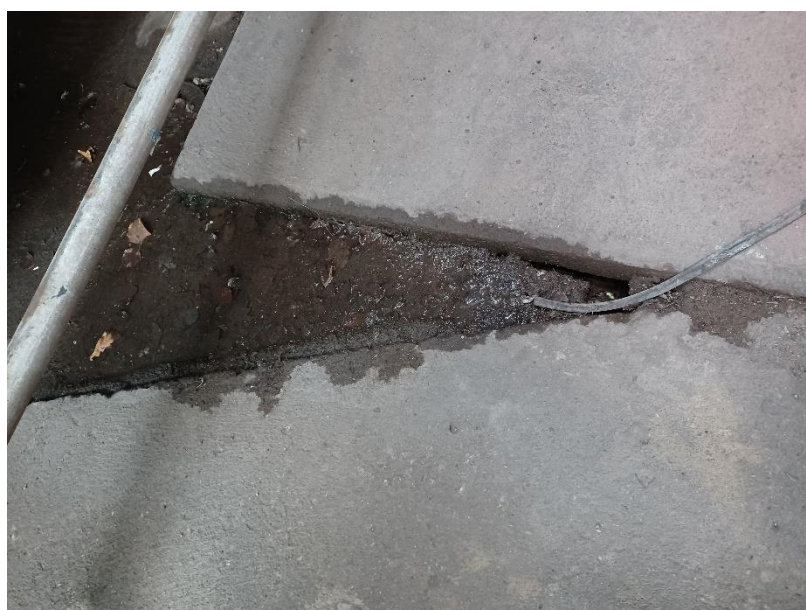
Skader på belægning ved AFFU-tank
