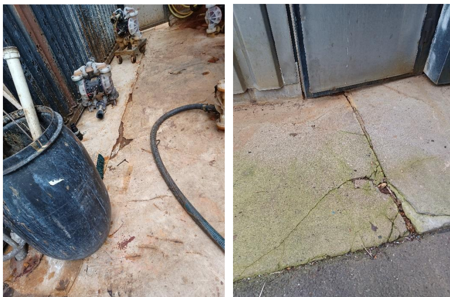
Skader på belægning ved Neutralisationsanlæg
