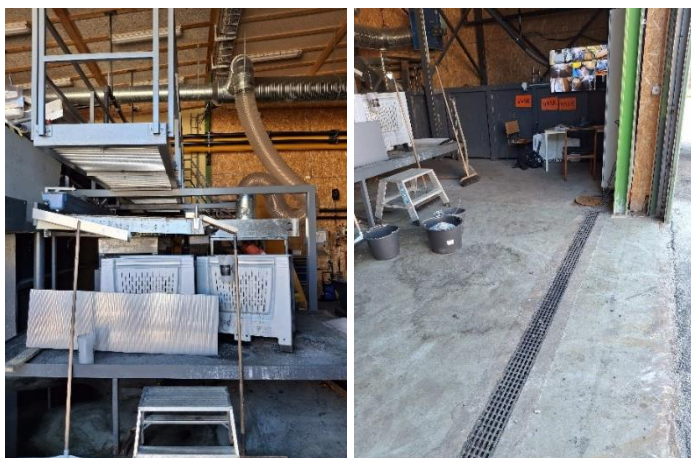
Vådsorteringsanlæg med etableret ACU-dræn
