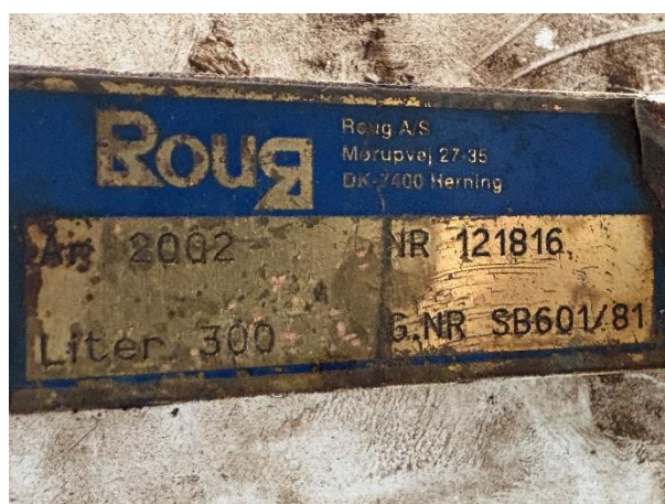
Figur 9: Mærkeplade på olietank i BBR-bygning nr. 10. Den stemmer overens med teknisk anlæg 2.
