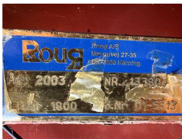
Figur 10: Mærkeplade på olietank i BBR-bygning nr. 12. Den stemmer overens med teknisk anlæg 4.
