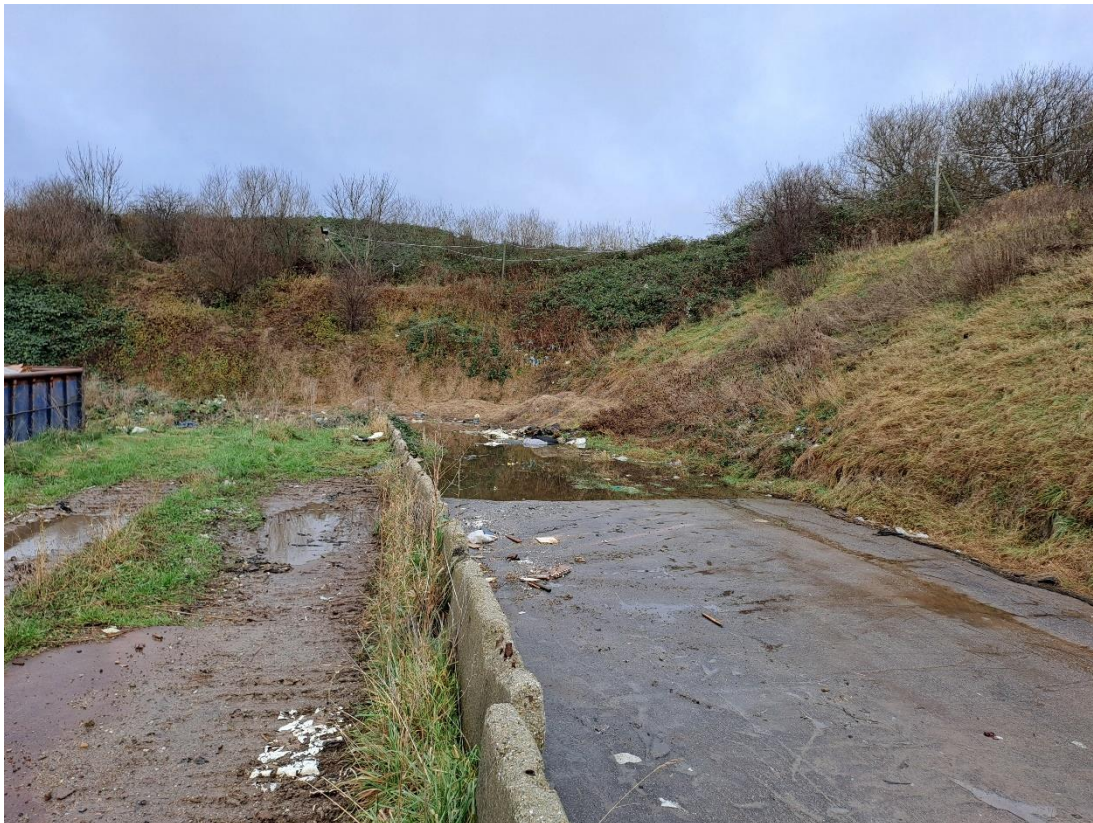
Figur 5: Billede taget fra rampe. Bagved observeres affald op ad skrænter og flydende i en større mængde regnvand
