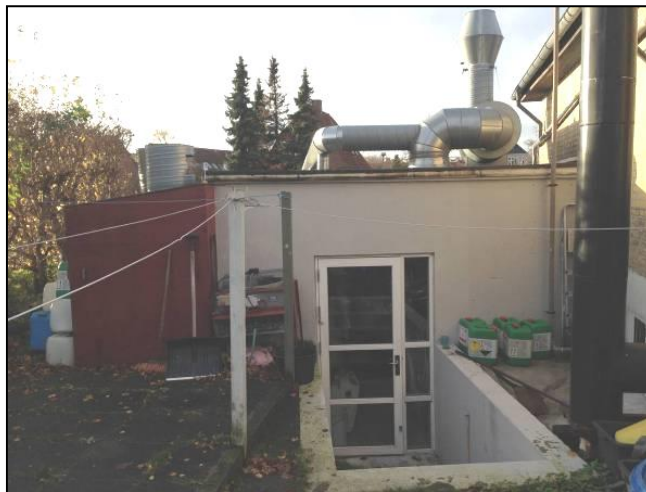
I det røde skur til venstre er kompressoren. Afkast ses på taget af bygningen. Foto fra tilsyn 2020
