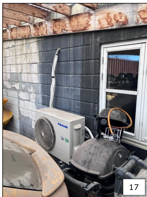
Foto 17 af virksomhedens luft til luft-varmepumpe, som findes under halvtaget.
