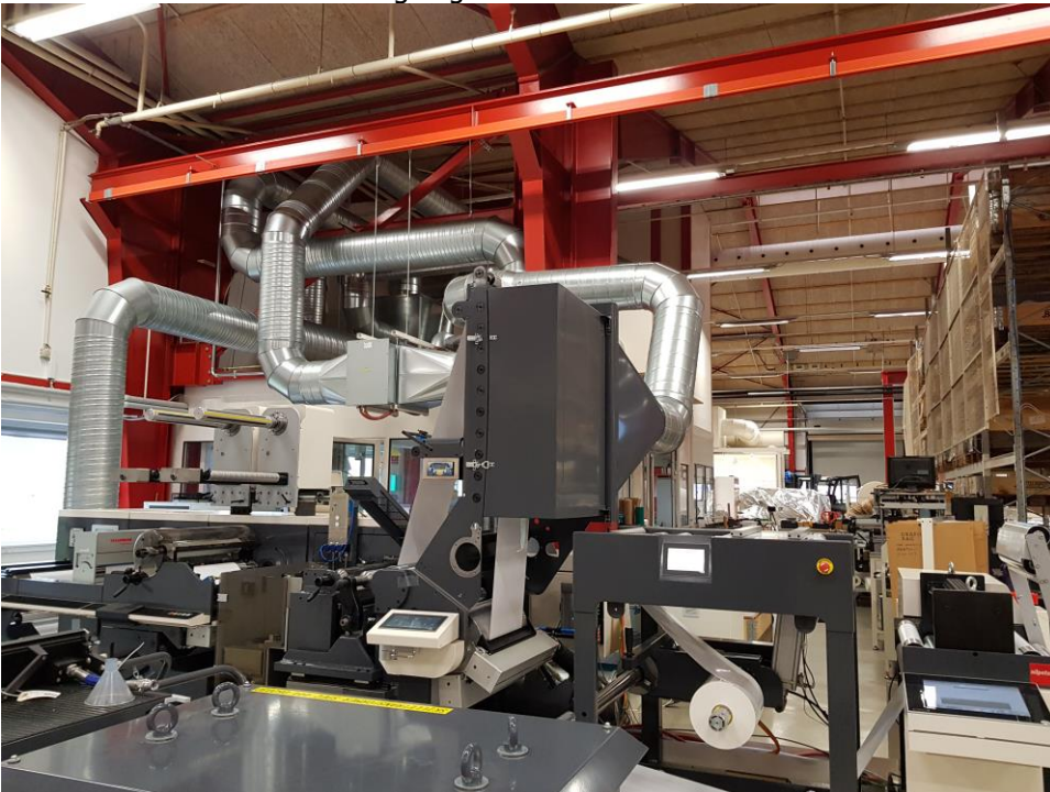
Billede 12 – Ventilation – udsugning
