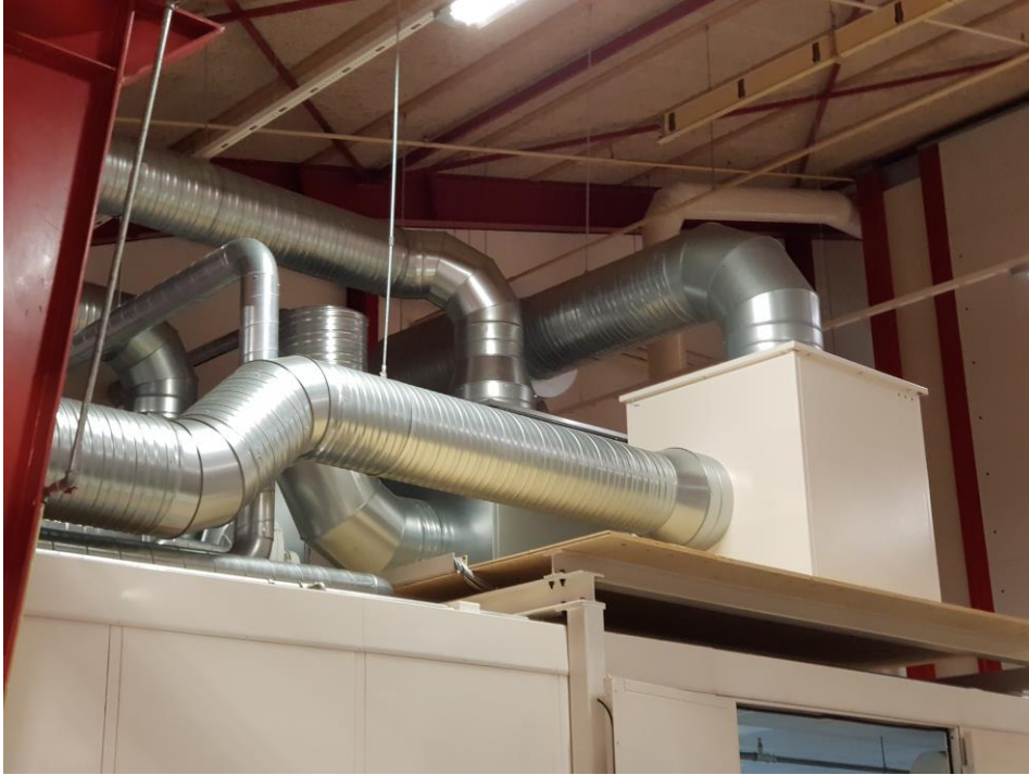
Billede 13 – Ventilation – udsugning
