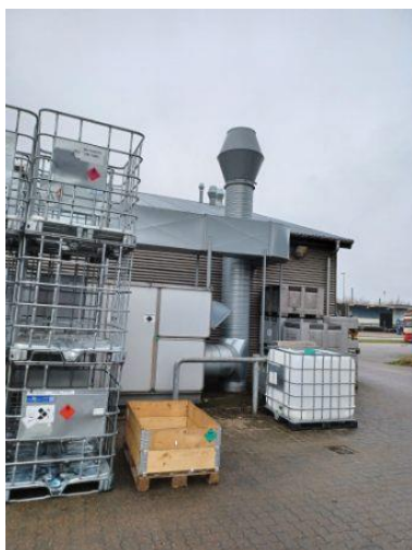
Ventilationsanlæg til procesudsug i hal 2.
