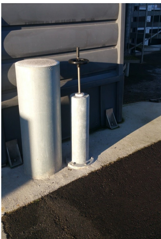
Drejestik til manuel omkobling af afspærringsventil ved tank til ammoniakvand
