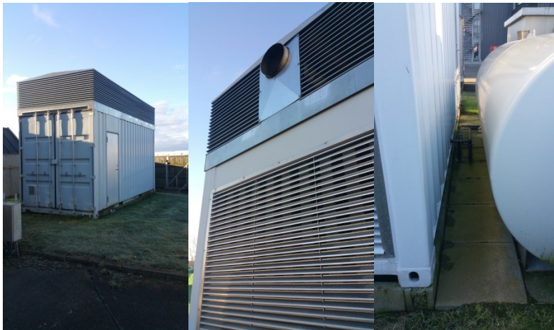
Nødgenerator, afkast og olietank
