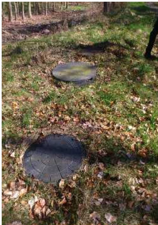
Sandfang, olieudskiller og prøvetagningsbrønd.
