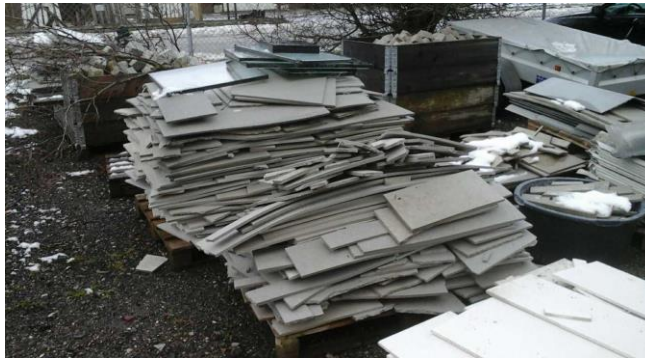
Oplag af affald – gips (det oplyses, at container er på vej)
