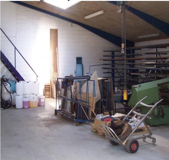
Rør til højre og dunke med propylenglycol til venstre
