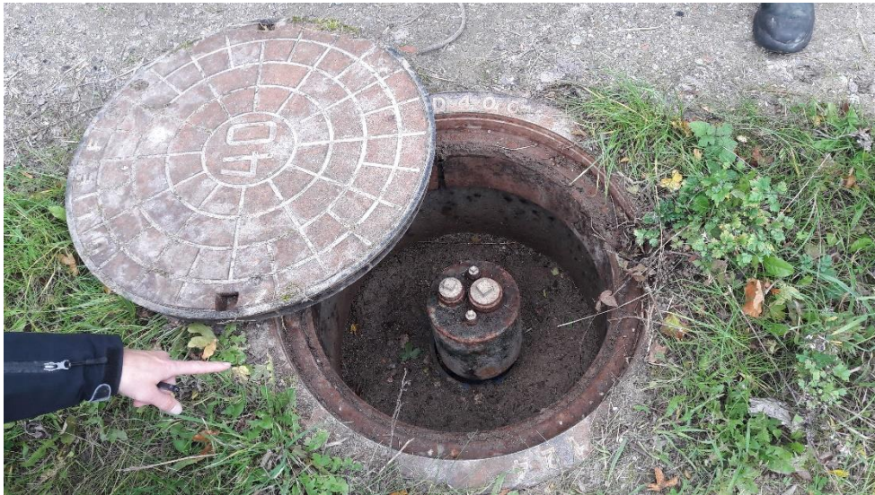
Aflåst brønddæksel over grundvandsboring.
