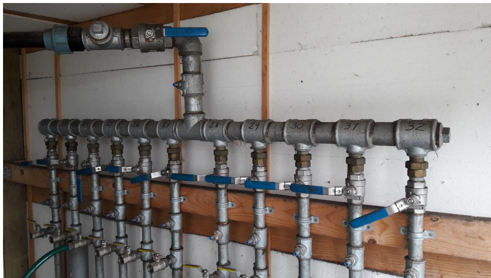
Deponigas – fra gashuset
