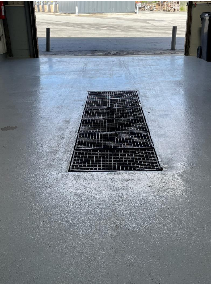
Afløb i vaskehal
