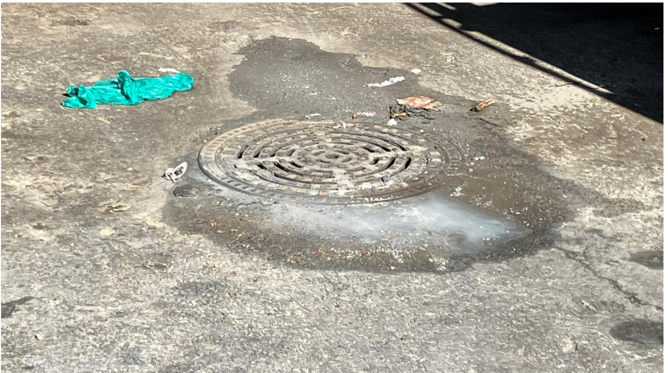
Afløb i vaskeplads
