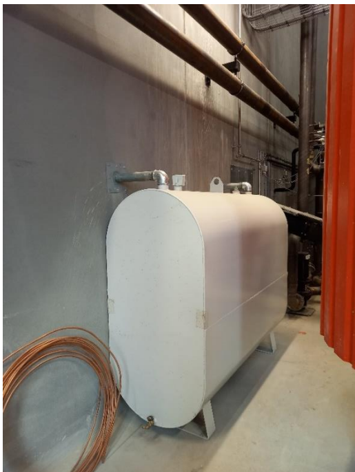
Figur 8. Den nye olietank i flishallen.
