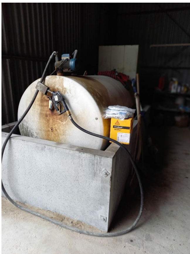
Figur 4. Tank til diesel i garagehal 7.
