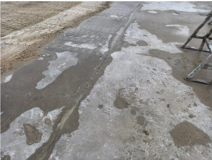
Figur 6. Belægningen på vaskeplads til fritlægning af elementer og vask af forme.
