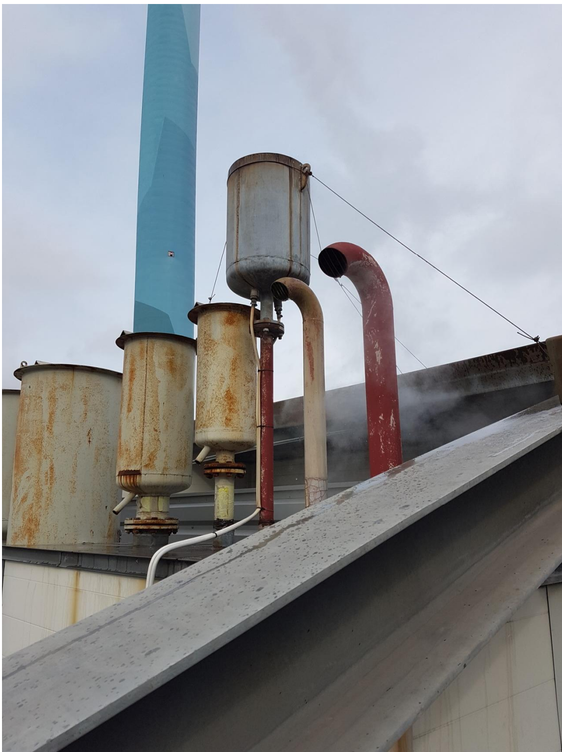
Figur 6: Dampafkast V2 efter støjdæmpning
