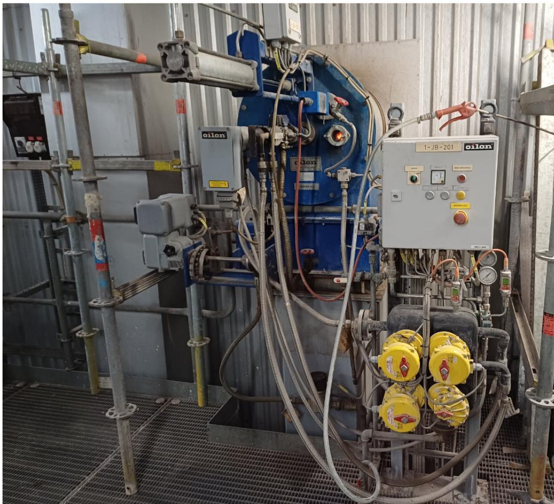
Foto 1. Støttebrænder er installeret.
