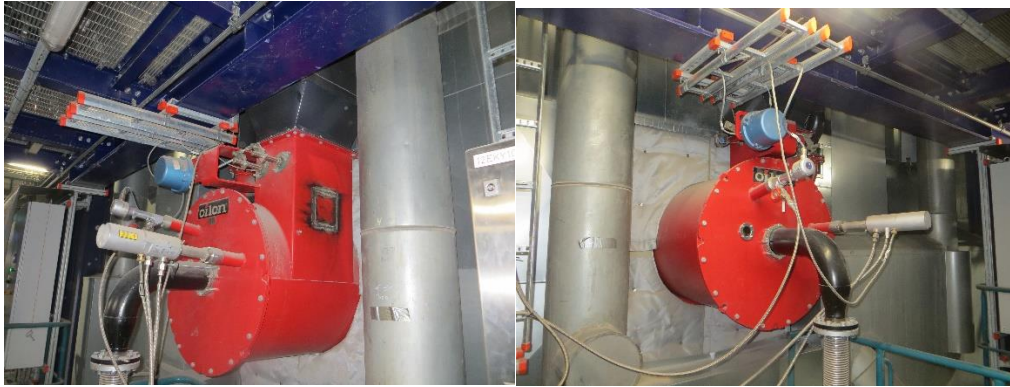
En støttebrænder på hver af ovnene, med gasinstallationer.
