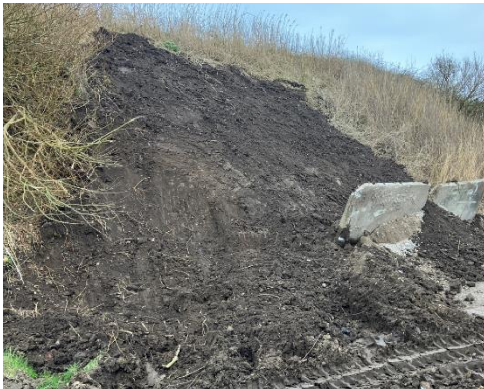
Figur 7. Foto af skred i det nordlige skråningsanlæg. Taget af virksomheden den 19. marts 2024
