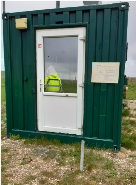
Figur 3. Container/bygning med gasmodul
