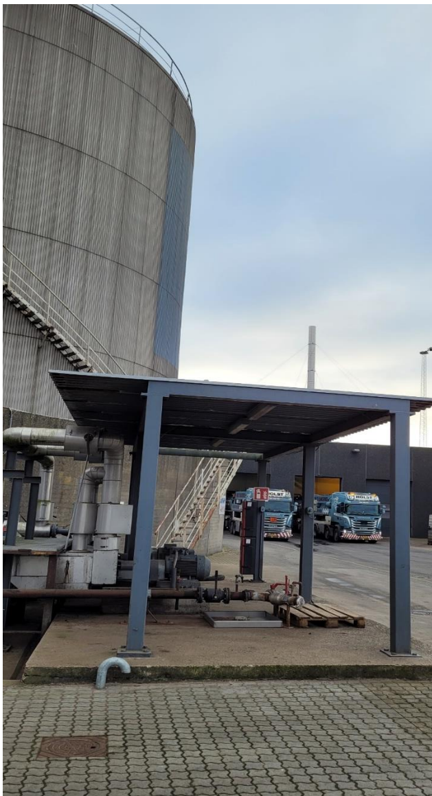
Pumpehus ved den store tankgård.
