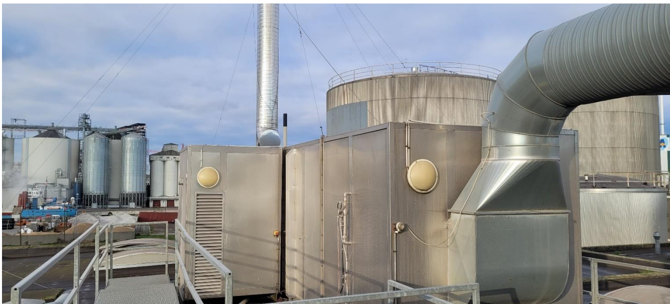
Infuser lugtreanseanlæg til luft fra udsugning ved processer.
